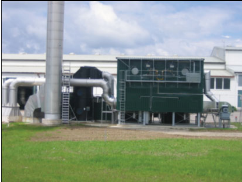
Abbildung 1: RTO-Anlage mit Wäscher
