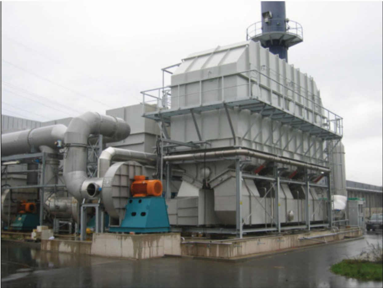
Abbildung 6: RTO-Anlage der neuesten Generation
