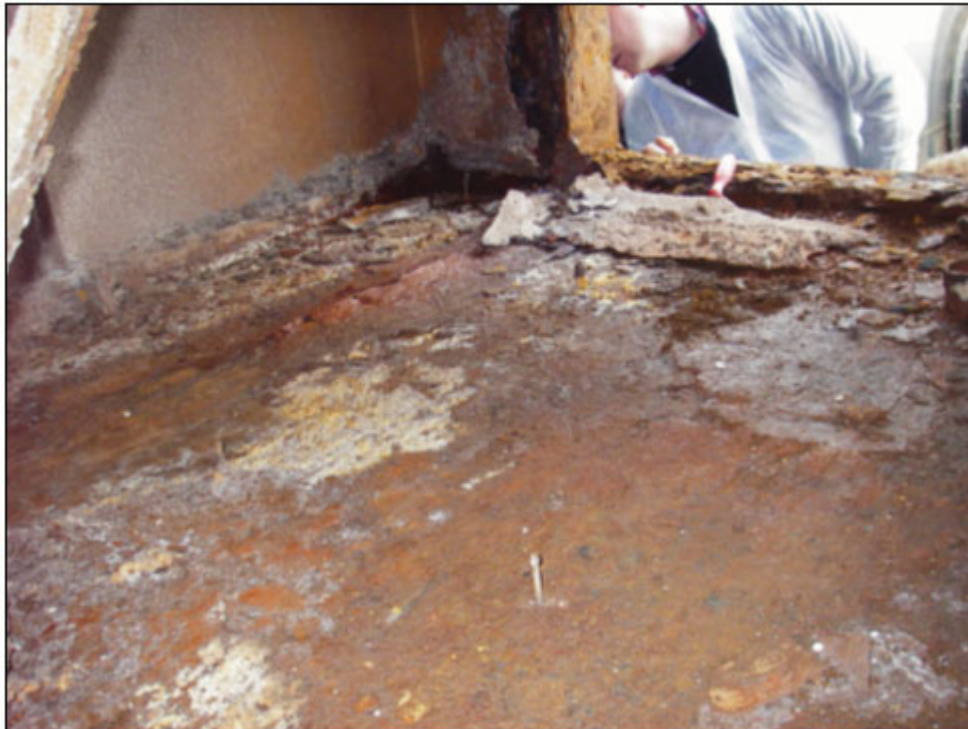
Abbildung 4: Korrosion im Rohgaskanal
