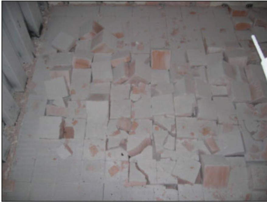
Abbildung 2: Siloxanproblematik in RTO-Anlagen, zerstörte Wärmetauscher
