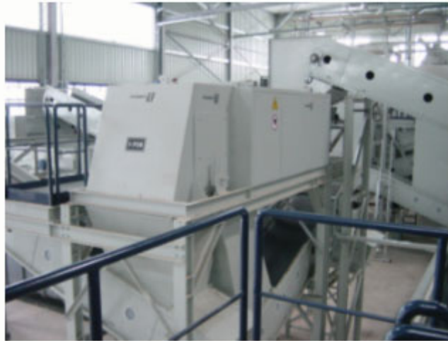
Abbildung 2: Wirbelstromscheider in einer EBS-Anlage
