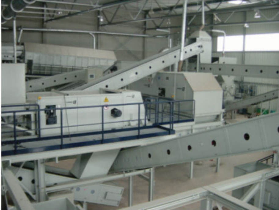
Abbildung 11: Blick in eine EBS-Anlage mit Wirbelstromscheider, links, und Induktionssortiersystem mit Nahinfrarotkamera in Kombination, rechts
