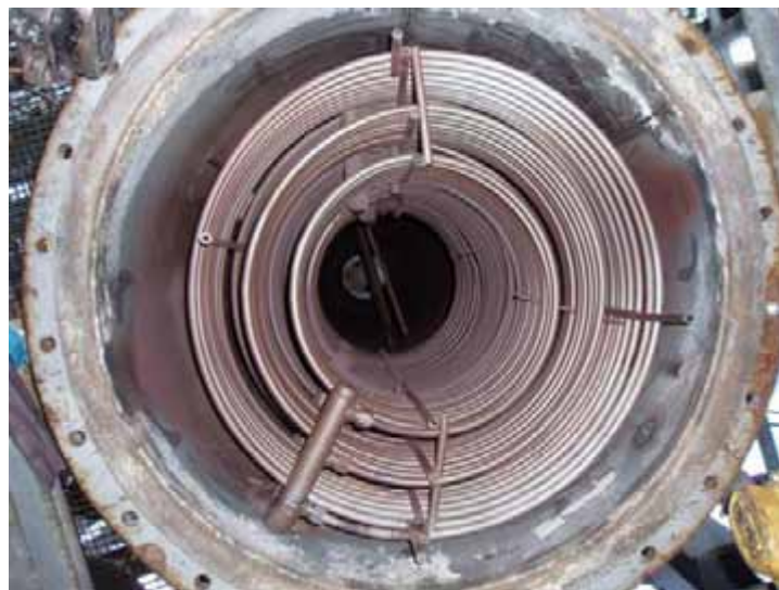
Abbildung 4.7: Wärmeübertrager in der Pilotanlage (Ansicht: von unten in der Anlage blickend)
