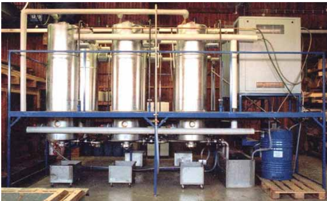
Abbildung 3.2.1: Pilotanlage für die Extraktion von Rinde im halbtechnischen Maßstab (Gesamtfassungsvermögen 900 Liter)
