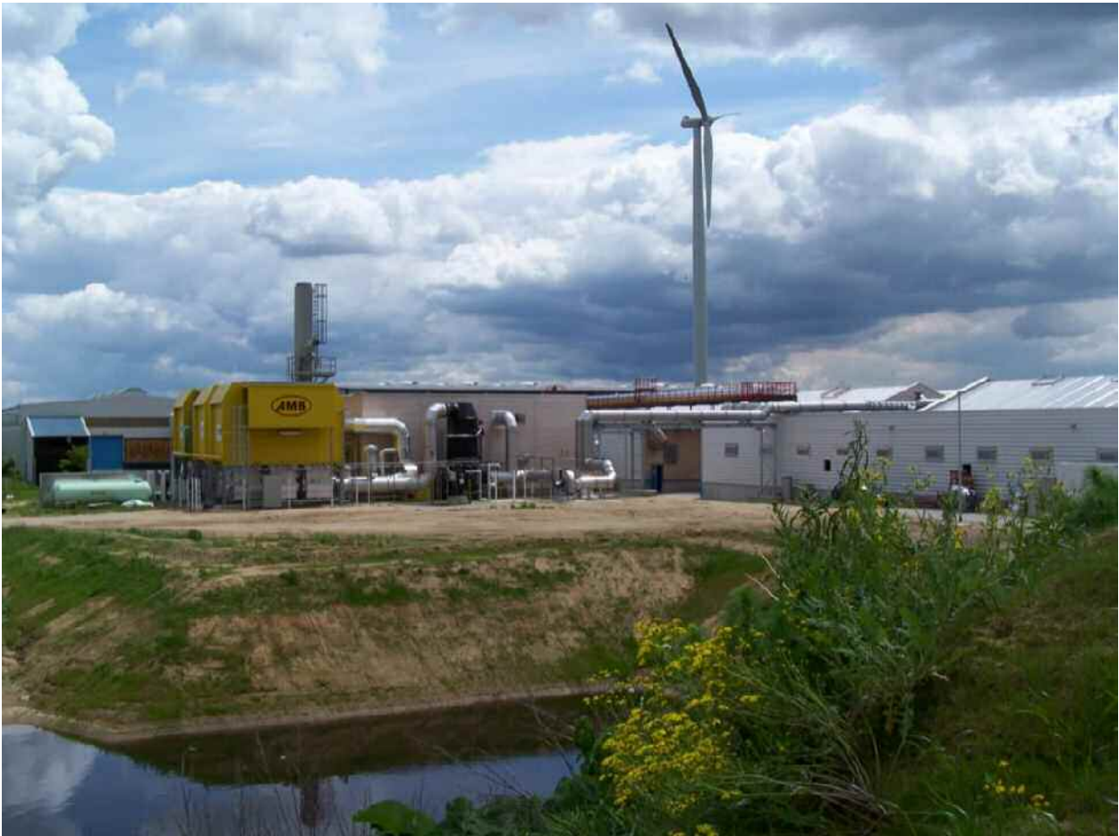
Abbildung 1 Erweiterte MBA Schwanebeck, Blick auf die Abluftreinigungsanlage
