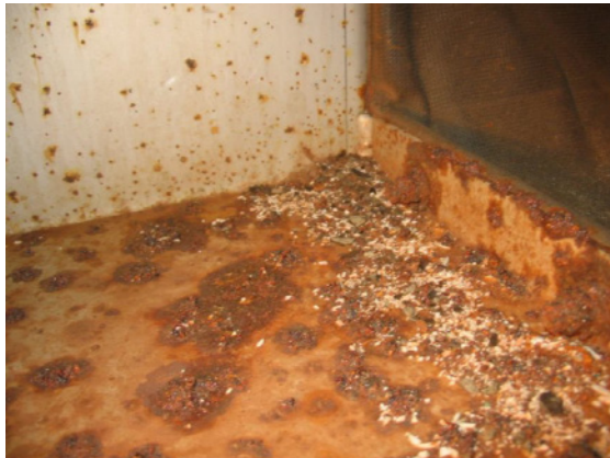
a) Rohgaskanal (Lochfraß)
