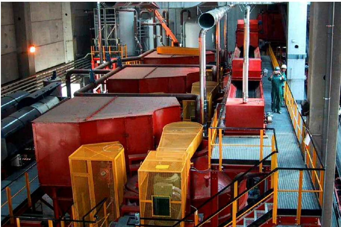
Abbildung 4 Naß-mechanische BTA Aufbereitung in Ca' del Bue, Verona – linker Rand Eindickung, im Hintergrund BTA Gritabscheidung
