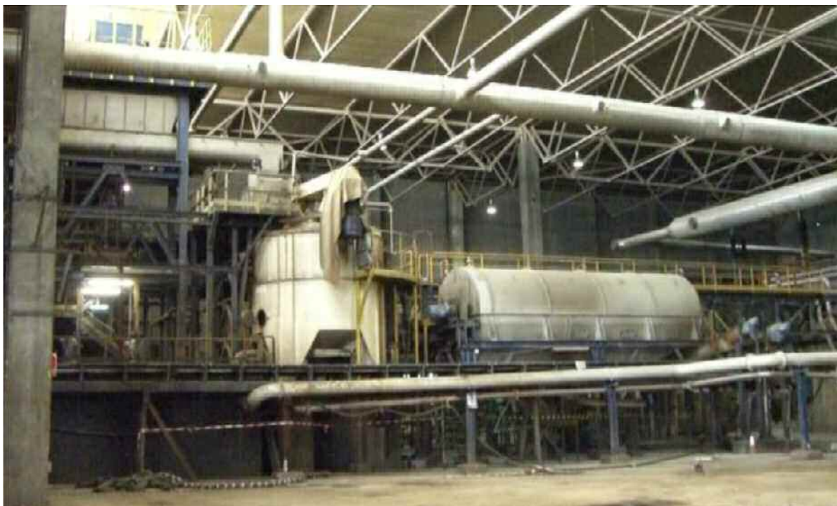
Abbildung 9 Naß-mechanische Aufbereitung Ecoparc I (vor Umbau)
