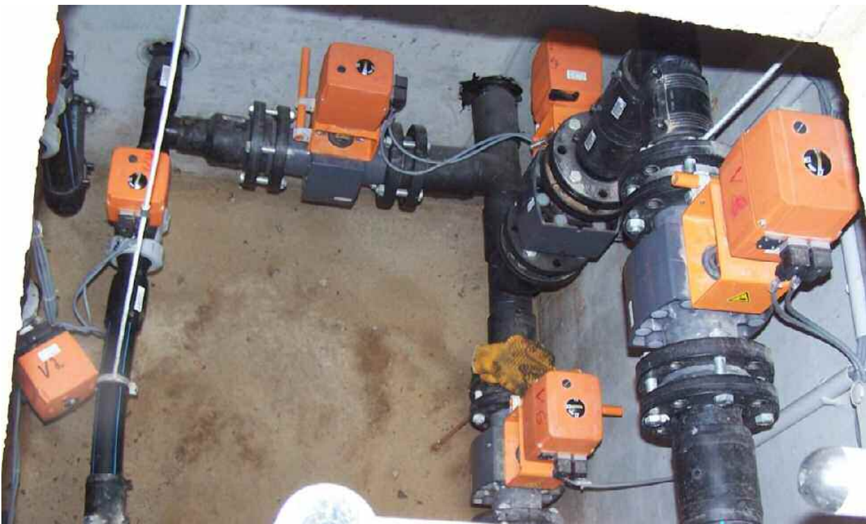
Abbildung 2 Ein zusätzlicher Armaturenschacht stellt die Redundanz der Anlagenteile zur Bewässerung sicher
