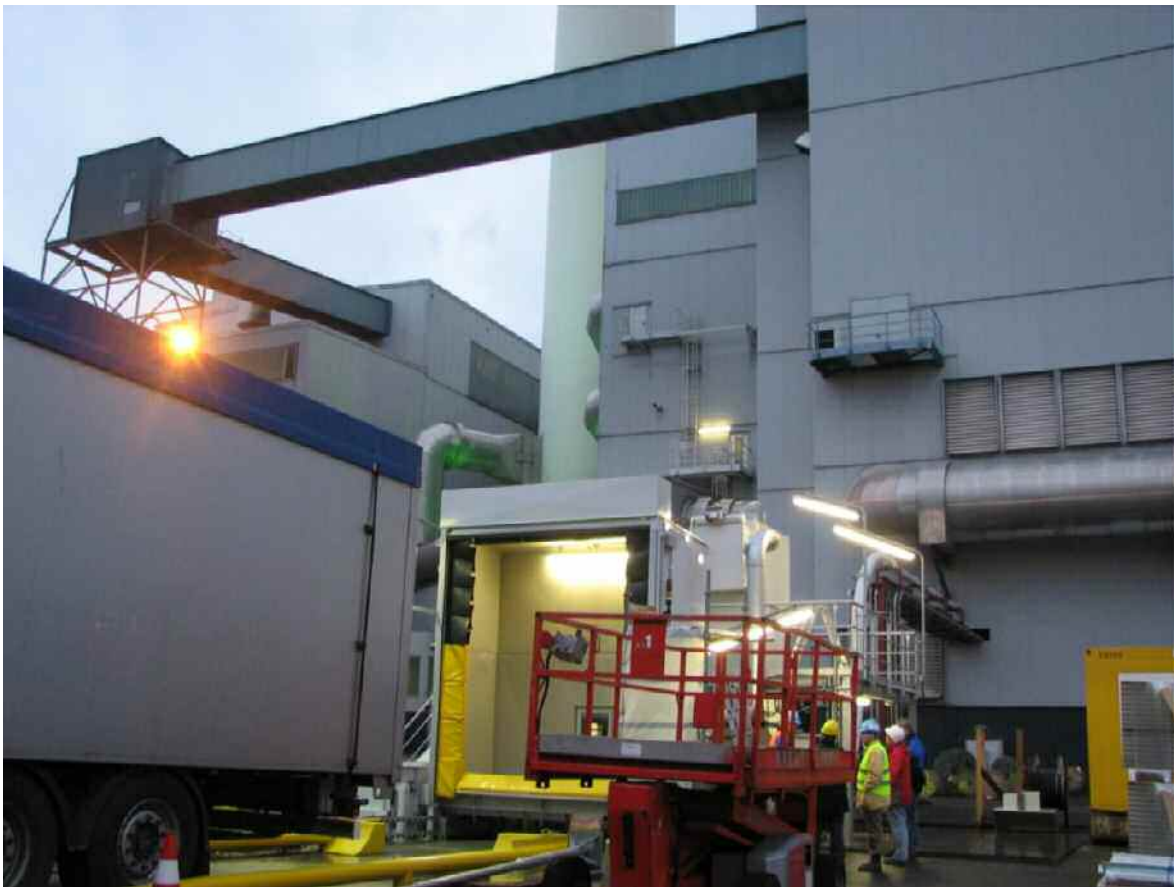
Abbildung 5 Walking-Floor-Entladung und Kompaktannahmestation am Kraftwerk Flensburg
