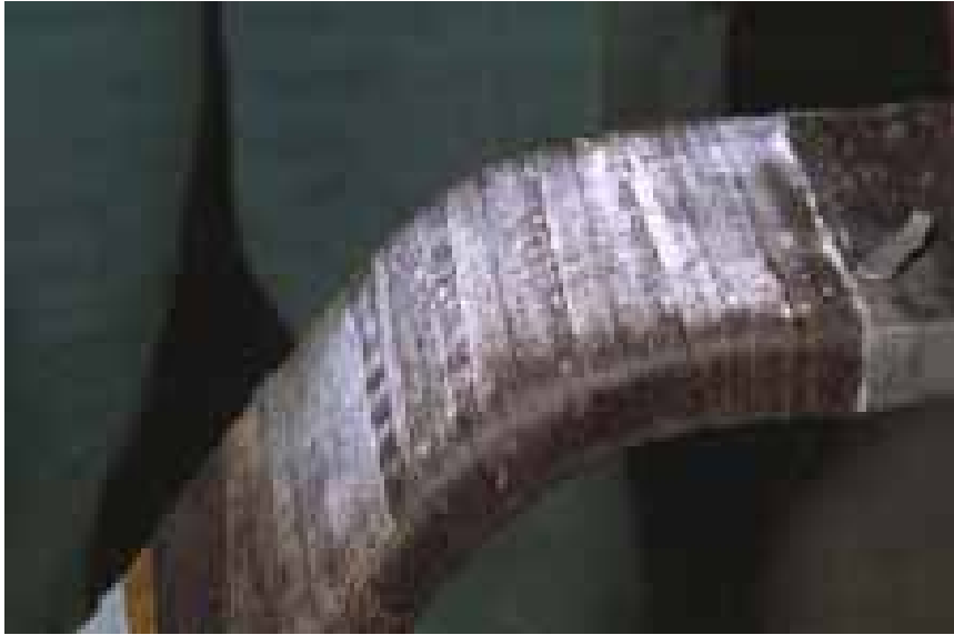
Bild 3.31: Beschädigter Ständerstab im EGS-Bereich [93]
