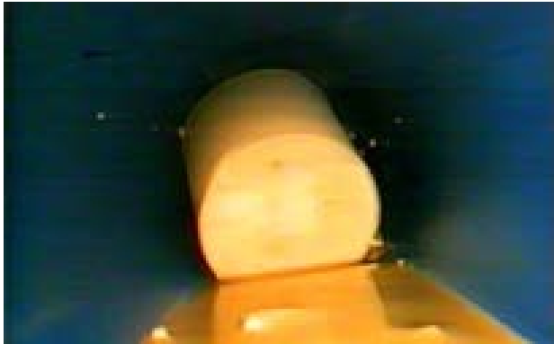
Bild 4.14: Fremdkörper im Dränagesystem (Saukopftunnel)
