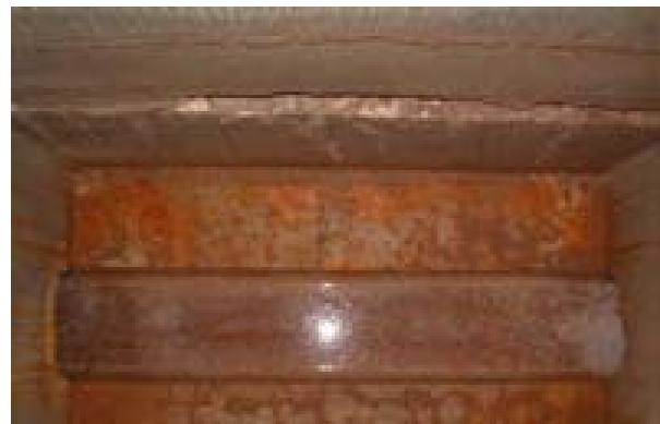
Bild 4.10: Roststäube im Dränagesystem des Hochwaldtunnels
