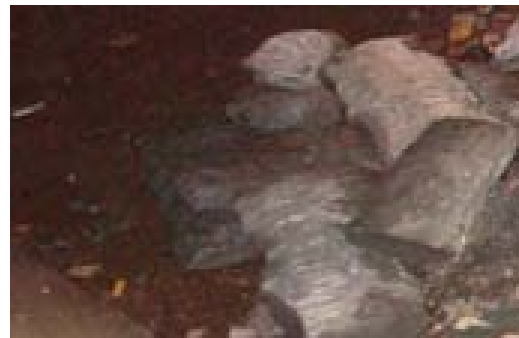
Bild 4.3: Spülreste aus der Drainage des Hochwaldtunnels nach der Firstraumverfüllung
