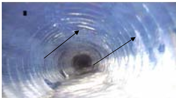
Bild 4.4: Versinterter Sickerschlitz eines Dränagerohres (Saukopftunnel)
