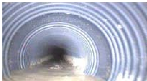
Bild 4.5: Versinterungen im Bereich der Fließfläche eines Wellrohres (Saukopftunnel)
