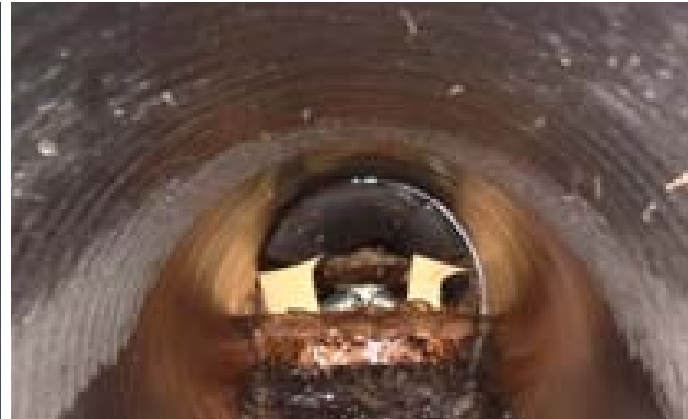
Bild 4.15: Strömungsbeunruhigung in Folge Fremdkörper im Dränagerohr (Rennsteigtunnel)
