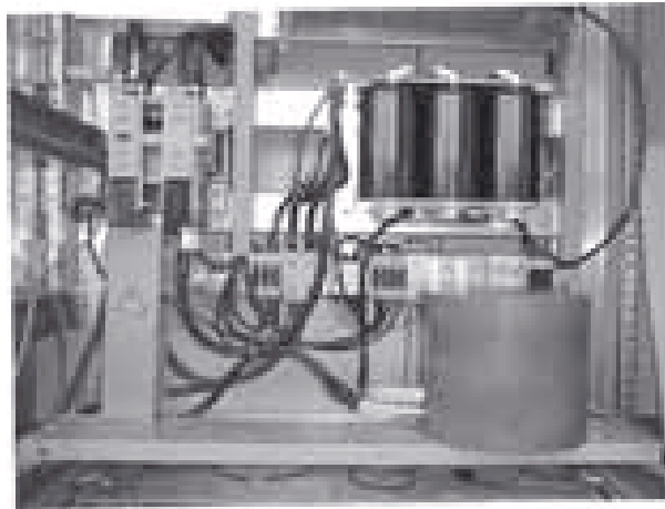
Abbildung 37: Aufbau des 30 kW DC/DC Stellers im Schaltschrank ohne Verkleidung.
