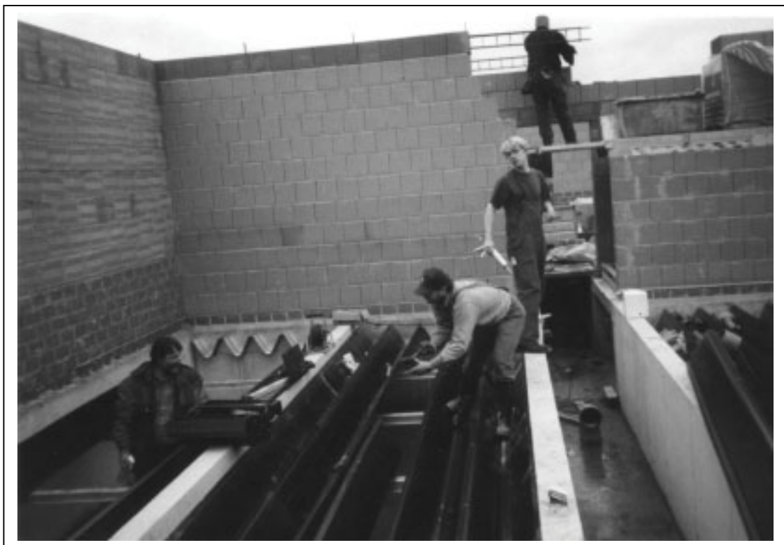
Abb. A.11: Spülrinnen: Montage der Rinnen in konventionellen Güllekeller
