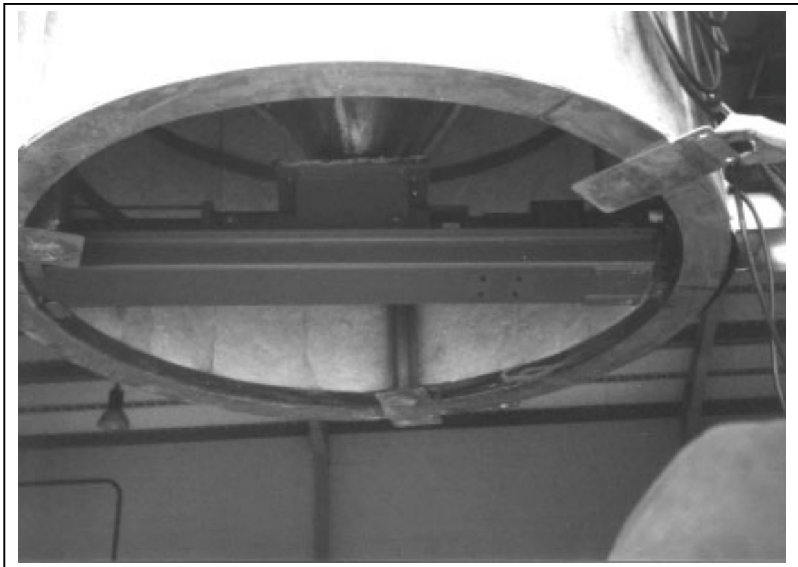
Abb. A.7: Sedimentationsbehälter (von unten): Schlammpumpe mit Trogeinlauf
