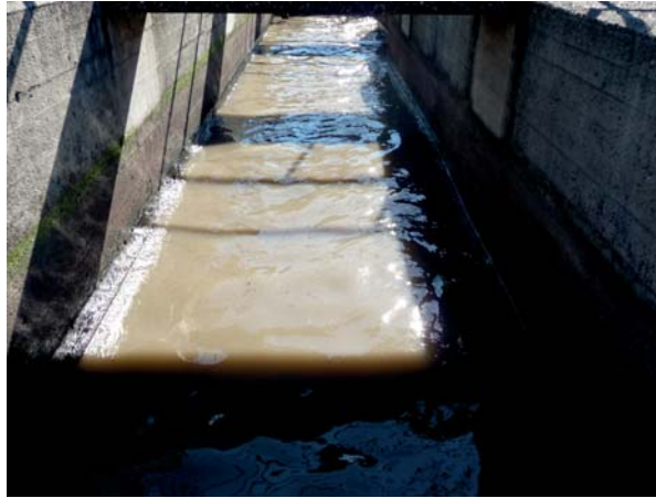
Abb. 3.28: Zulauf zum Vorklärbecken im Klärwerk Ulm.
