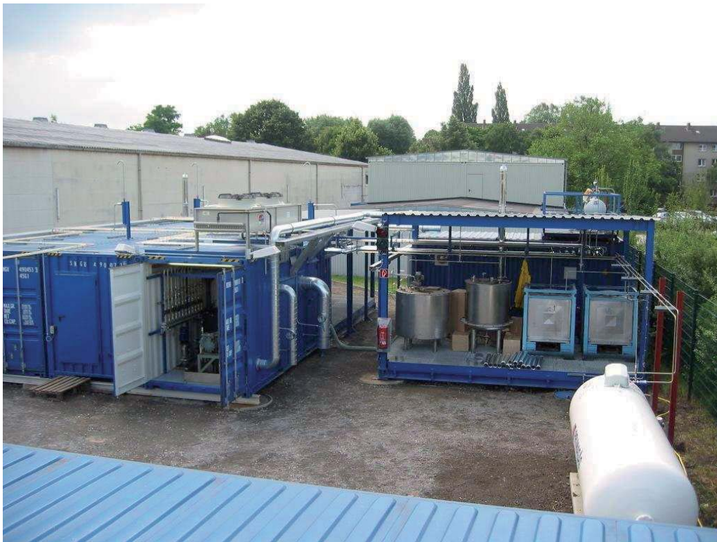
Abb. II.XIII.01: Emulsionsaufbereitungs-Pilotanlage mit Propantank
