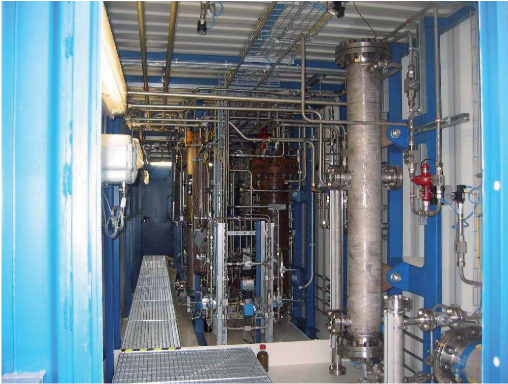
Abb. II.XIII.03: Verrohrung und Regeleinrichtung der Pilotanlage
