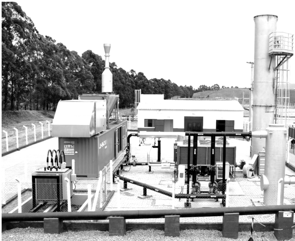
Figura 2 – Usina termelétrica de geração de energia a partir de biogás de aterro sanitário em Santa Maria/Rio Grande do Sul, com potência instalada de 1 MW.
