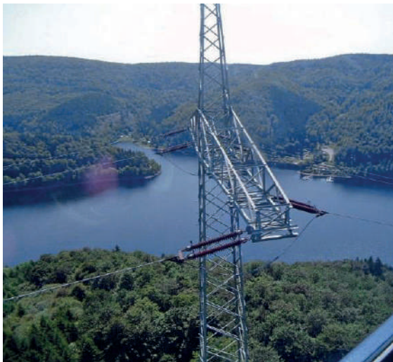
Abbildung 118: Einer der 110-kV-Masten der Harzring-Freileitung (Bialek 2019)
