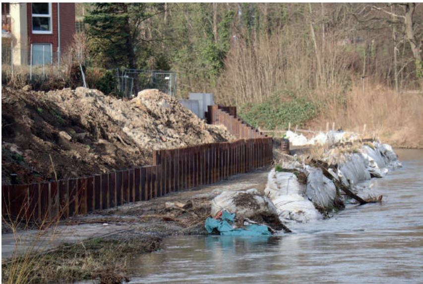
Abbildung A3-36: Hochwasserschutzmaßnahme "Bleicherstraße" in Hildesheim
