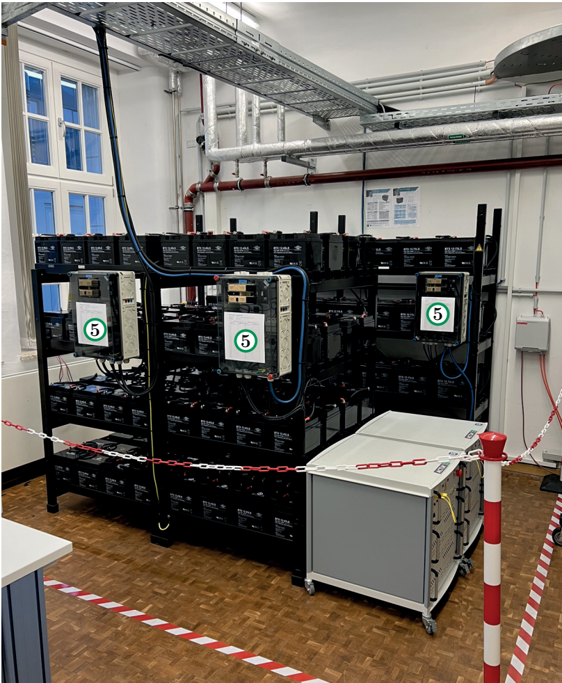
Abbildung 3.11 – Aufnahme des Labors „Aktive Verteilnetze“. ⑤ Batteriespeicher für die Umrichter
