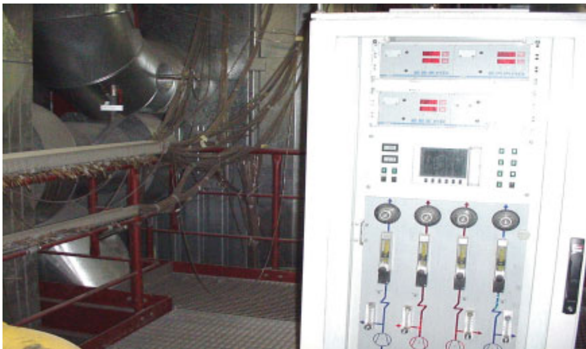
Abbildung 16: Messgasschrank mit Schläuchen der angeschlossenen Wandmessstellen
