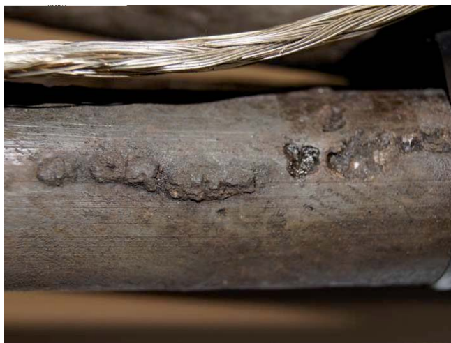
Abb. 1.1: Bleifraß am Bleimantel eines Papiermasssekabels
