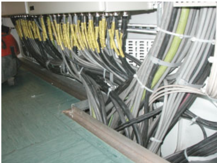
Abbildung 2.4: Kabelstränge in einem hinter der Brücke liegenden Elektronikraum. Die Kabel führen über den doppelten Boden bzw. über die Decke zu den Anzeigen und Systemen auf der Brücke sowie zu weiteren Elektronikräumen im Deck unterhalb der Brücke.
