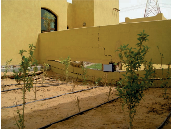
Abbildung 1.2: Beispiel einer durch den kapillaren Kollaps stark beschädigten Begrenzungsmauer in einer Wohnsiedlung in Abu Dhabi (Vandanapu u. a., 2016).
