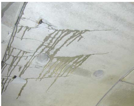
Abbildung 2.3: Hauptsächlich durch Torsion verursachte Risse in Tübbingren
