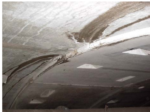
Abbildung 2.4: Fugenversatz durch lokale Überbeanspruchung der Koppelstellen
