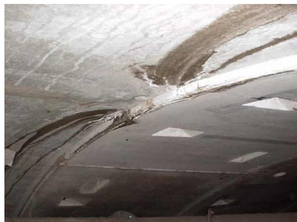
Abbildung 2.4: Fugenversatz durch lokale Überbeanspruchung der Koppelstellen
