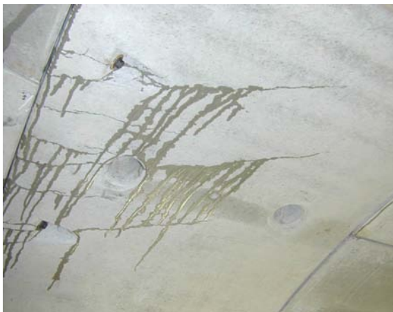
Abbildung 2.3: Hauptächlich durch Torsion verursachte Risse in Tübbingen
